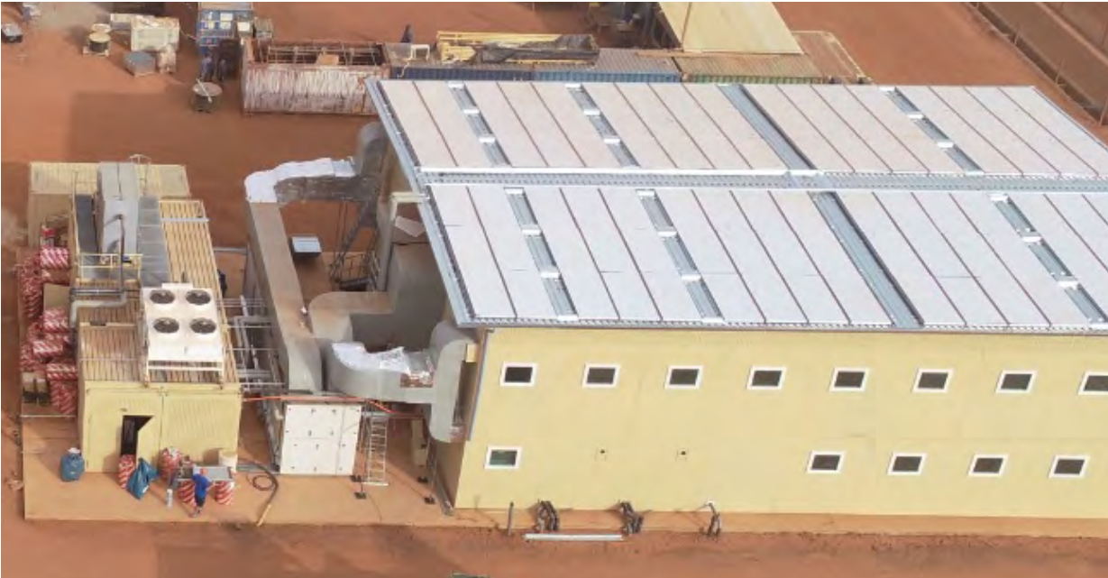
Einsatzwehrverwaltungsstelle in Mali – Rückkühler für die Kompressionskältemaschine sowie Nasskühlturm für die Absorptionskältemaschine auf der Technikzentrale links im Bild
