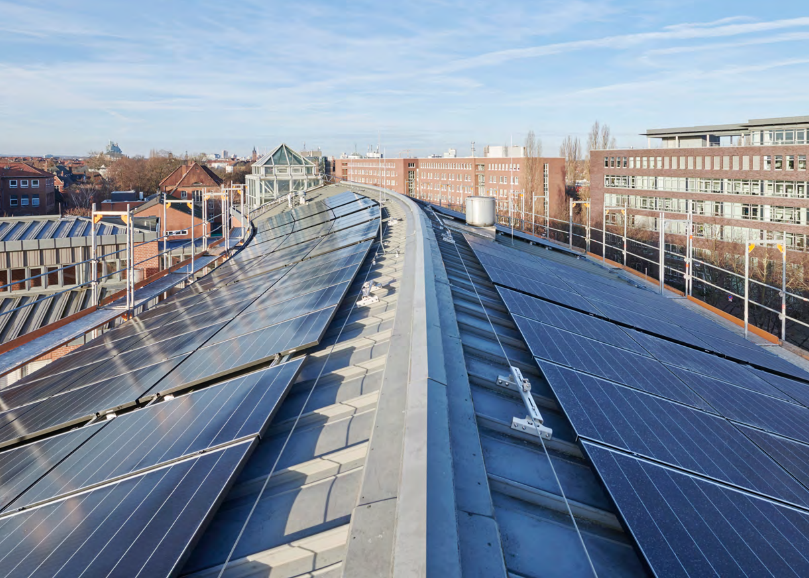
Photovoltaikanlage auf der Kurt-Schumacher Kaserne, Hannover
