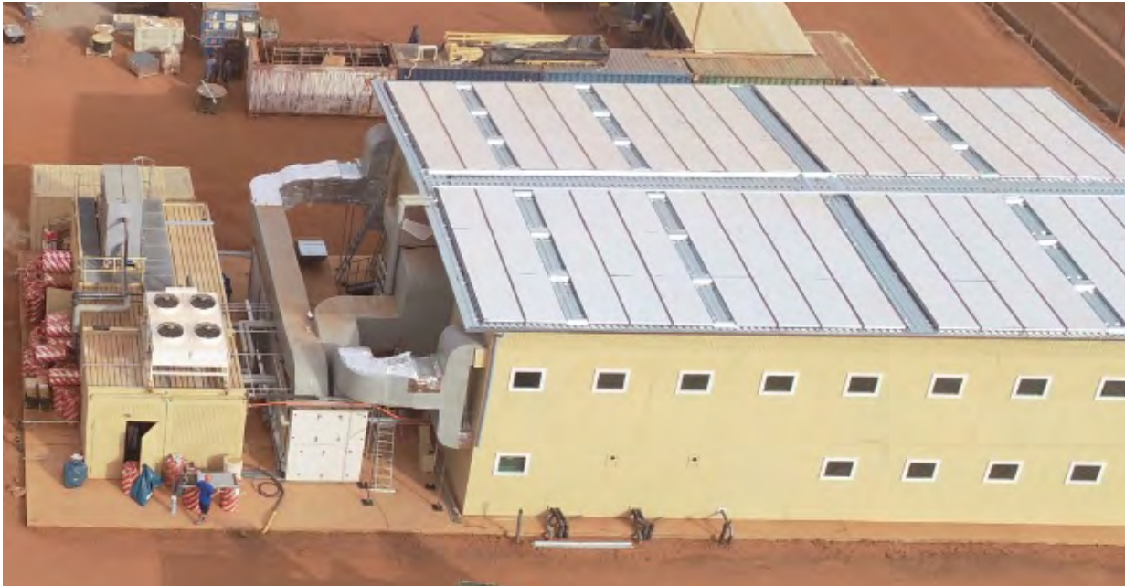
Einsatzwehrverwaltungsstelle in Mali – Rückkühler für die Kompressionskältemaschine sowie Nasskühlturm für die Absorptionskältemaschine auf der Technikzentrale links im Bild
