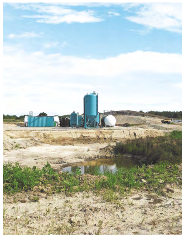
Abbildung 34: Grundwasserbehandlungsanlage, Quelle: Betrieb für Bau und Liegenschaften Mecklenburg-Vorpommern, Abteilung Bundesbau
