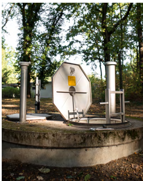
Abbildung 18: Ein Tiefbrunnen auf dem Gelände einer Bundeswehrliegenschaft, Quelle: Bundeswehr/ Jenny Bartsch
