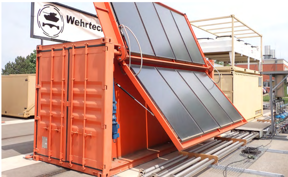
Abbildung 27: Solarthermie-Container aus dem Energiecamp zu Erprobungszwecken, Quelle: Bundeswehr
